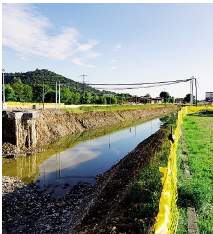
Il tratto in trincea allagato FOTO COLLEONI
